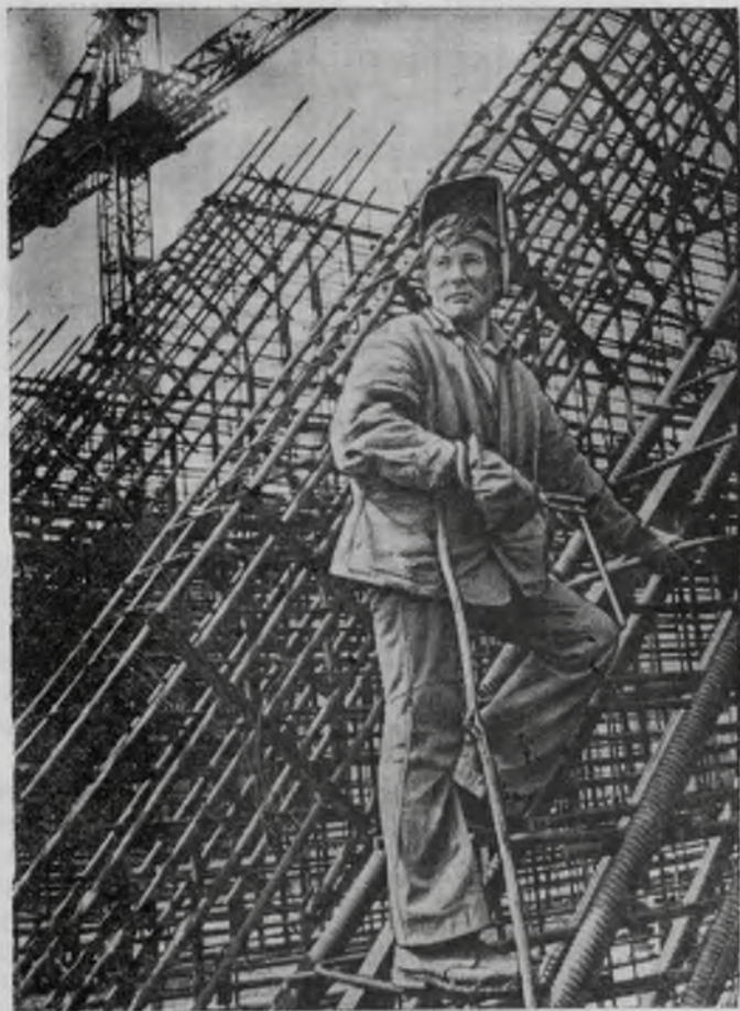
Электросварщик Л. Егоров один из тех, кто ведет монтаж подпорной стены плуза.
