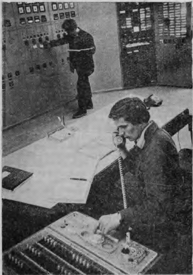
Главный щит управления открытого распределительного устройства Чебоксарской ГЭС. Вахту несут дежурные — инженер Г. Доменикин и монтер-электрик М. Душонков.
